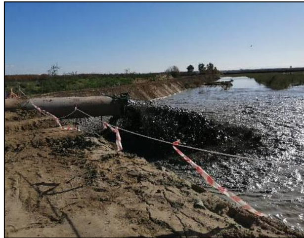
Ilustración 8. Vertido al vaciadero de Butano en la campaña 2021/22. Fuente: Tecnoambiente, 2022.
