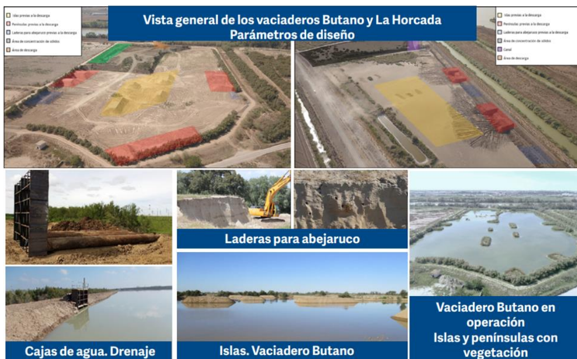
Ilustración 12. Secuencia de los trabajos realizados en los vaciaderos de Butano y La Horcada. Fuente: APS
